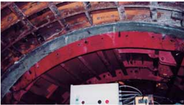
● トンネル打継部
